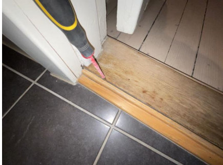
Synlig dukmembran ved dørterskel.
