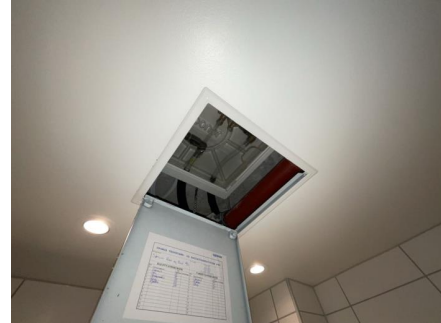
Fordelerskap over himling på badet.
