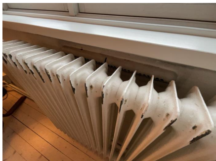
Original luftespalte under vindu.
