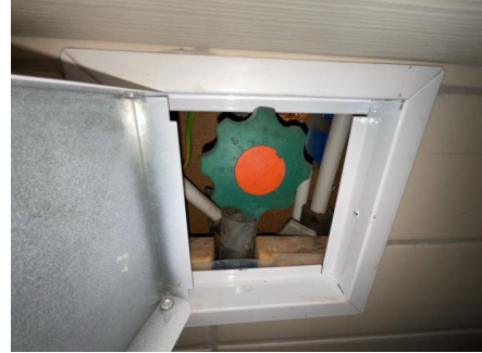
Stoppekran på baderommet.
