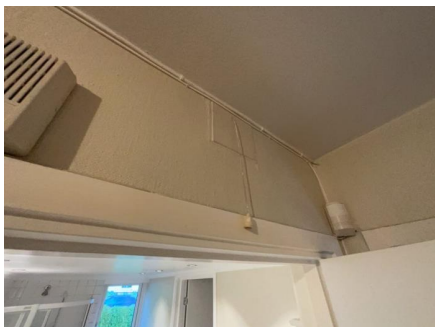
Luke over baderomsdør må åpnes.
