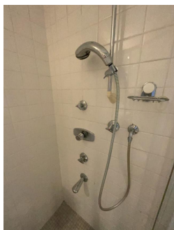
Skjulte rørstrekk på badetrommet.
