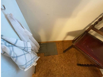
Det mangler gulvbelegg her på kjøkken.
