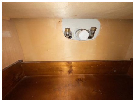
Blendede rørstusser i vegg på det minste soverommet.
