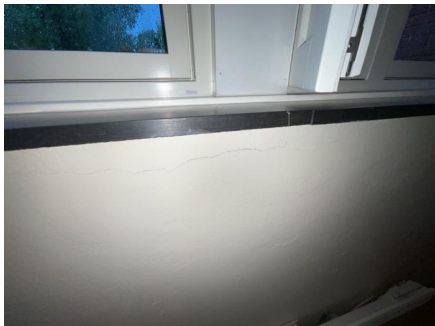
Sprekkdannelse i murvegg under soveromsvindu.
