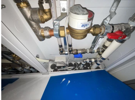
Fordelerskap med stoppekraner.
