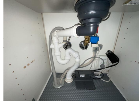
Rør i underskap på kjøkken. Lekkasjestopper.
