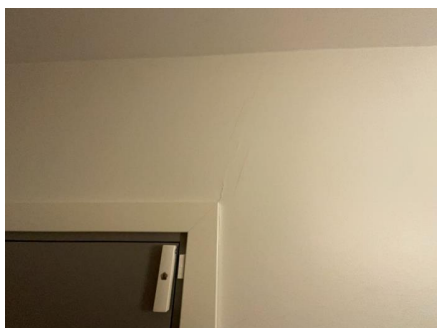
Riss i gipsplate vegg over inngangsdør har ingen praktisk betydning, skyldes bevegelse i bygningen.
