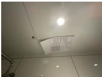
Test med løst ark viste tilfredstillende avtrekk.
