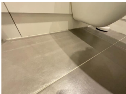
Ikke synlig drencspalte under toalettet.
