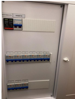
Sikringskap med automatsikringer plassert i innebod.
