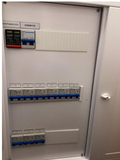
Sikringskap med automatsikringer plassert i innebod.
