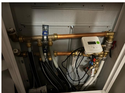
Fordelerskap vannbåren varme, plassert i innebod.
