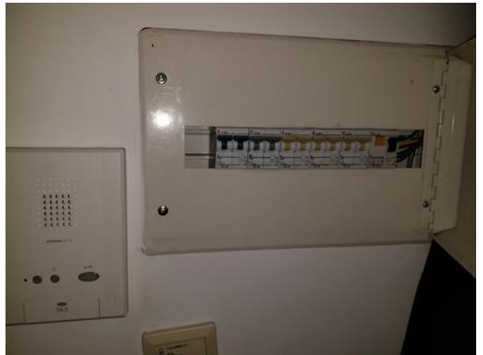
Elektrisk anlegg - [Sikringskap. ]
