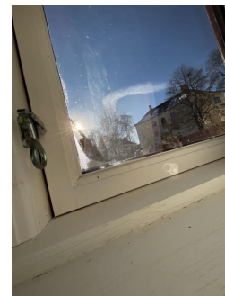
Kondens på innside av vindusglass i kjeller.
