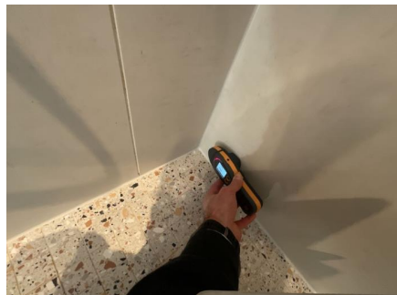
Protimeter fuktapparat gjorde utslag her.
