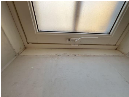
Bruksslitasje. Vinduet er utsatt for fuktighet.
