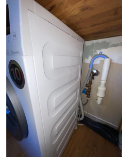
Opplegg til vaskemaskin. Lekkasjestopper.
