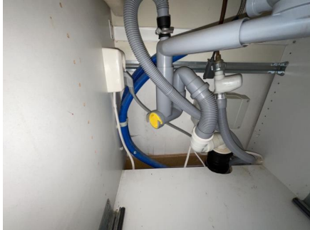
Rørpropplegg i underskap på kjøkken.
