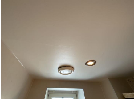
Avtrekkshentilen er noe løs.
