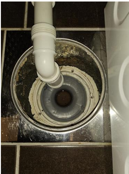
Avløpsrør (ink. sluk) - [Sluk ved vaskemaskin]
