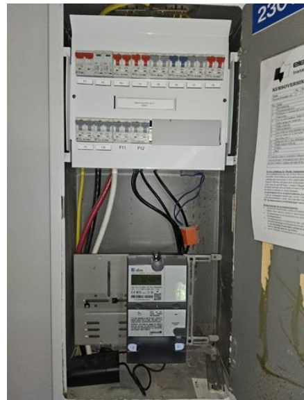
Elektrisk anlegg - [Sikringsskap]
