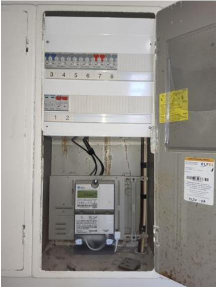
Elektrisk anlegg - [Sikringskap]
