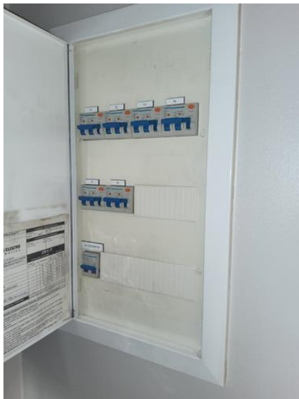
Elektrisk anlegg - [Sikringsskap]
