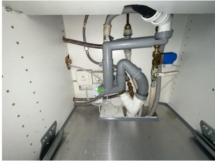
Røropplegg på kjøkken.
