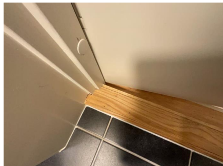
Luftespalte under dørbildet.
