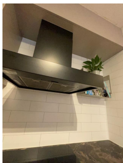
Avtrekkshette med spjeldløsning.
