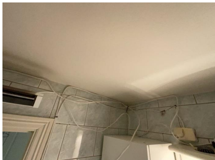
Løse ledninger. Ikke fagmessig utførelse.
