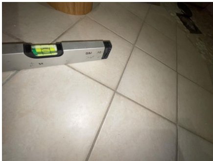
Svakt motfall på gulvet i retning sluk i dusj.
