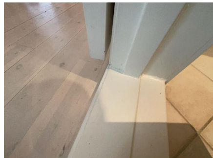
Luftespalte under dørbladet.
