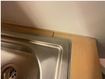
Liten sprekk i benkeplaten.
