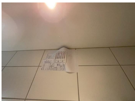
Test med løst ark viste tilfredstillende avtrekk.
