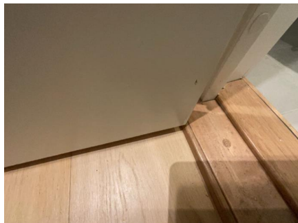
Luftespalte under dørbildet.
