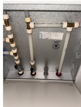
Samleskap med rørkurser og stoppekrane
