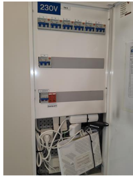
Elektrisk anlegg - [Sikringskapp.]
