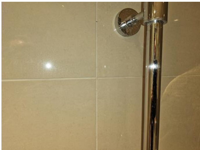
Kommentar - [Sprekker/riss flisfuger]
