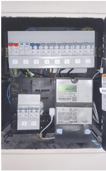
Elektrisk anlegg - [Sikringskap ]
