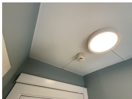
Brannvarsler (tilknyttet felles anlegg).
