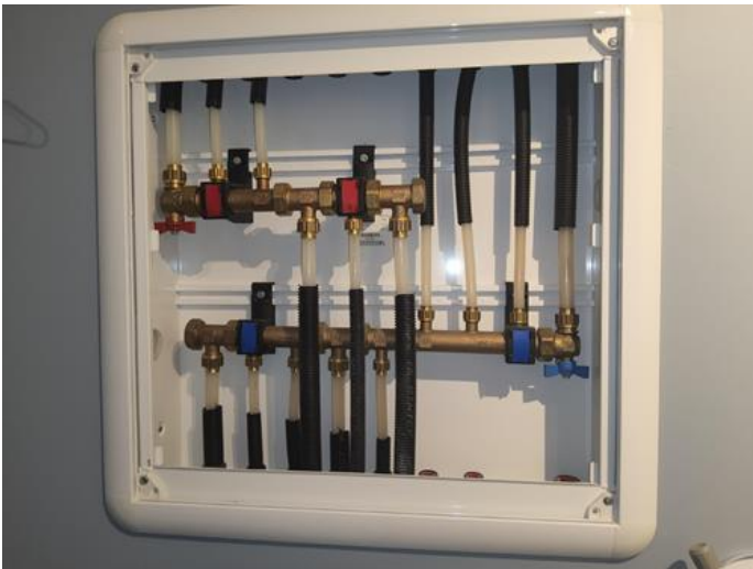
Vannrør (Sjekkpunkter utover det som er inkludert i andre rom) - [Fordelerskap for rør-i-rør ]
