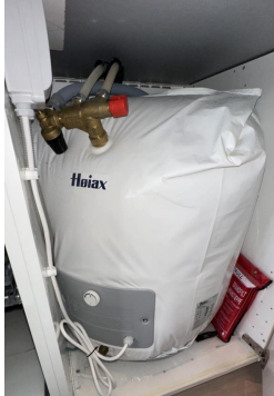
Varmtvannsbereder plassert i kjøkkenbenk
