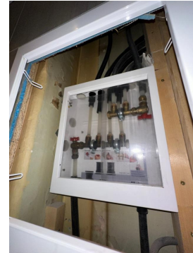
Samleskap med rørkurser og stoppekraner
