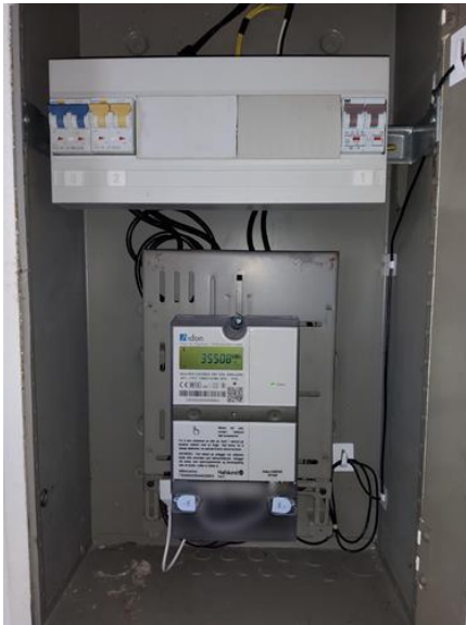
Elektrisk anlegg - [Sikringskap ]
