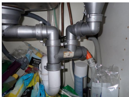
Kjøkkenbenk med vann og avløpsrør
