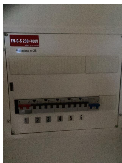
Sikringsskap plassert i entre/gang.
