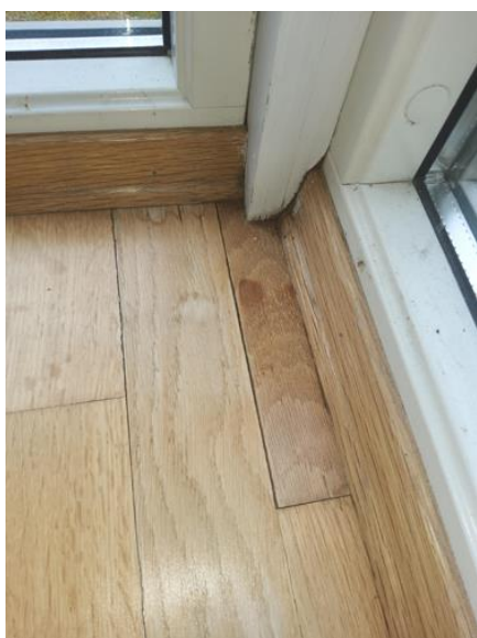
Overflater gulv - [Sprekker i parkettgulv på soverom 3]
