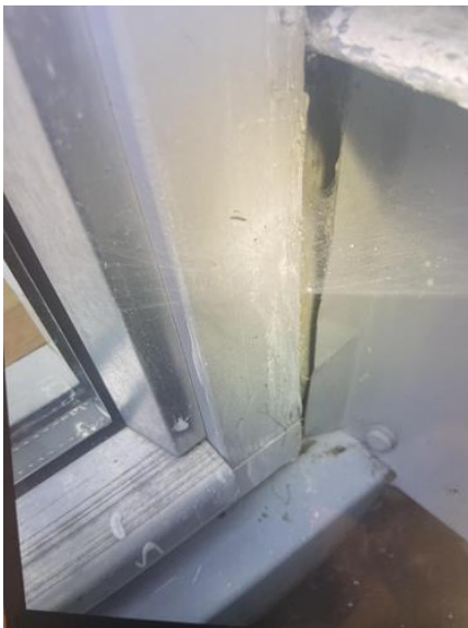
Fasader ink. kledning - [Utettheter på høyre side av vindu på soverom 2]
