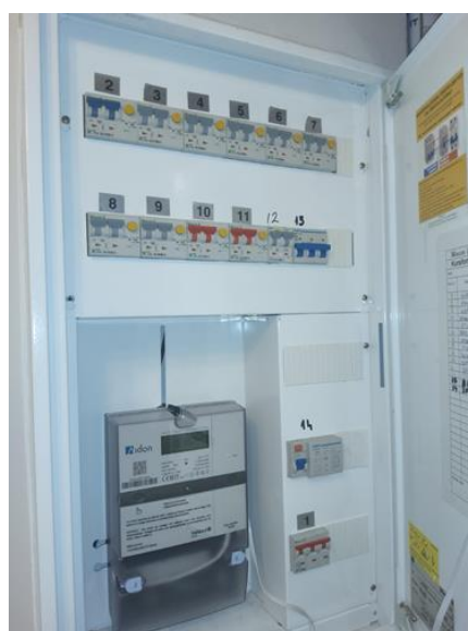
Elektrisk anlegg - [Sikringsskap ]
