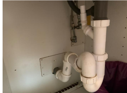
Rørapplegget kjøkken. Waterguard bør monteres.
