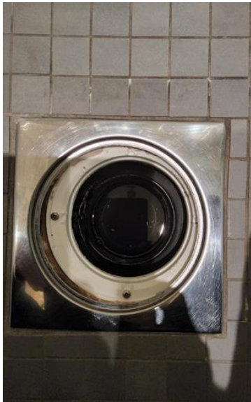
Avløpsrør (ink. sluk) - [Sluk på bad 1.etasje ]
