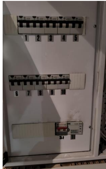
Elektrisk anlegg - [Sikringskap ]
