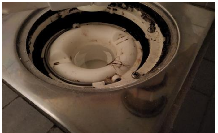
Avløpsrør (ink. sluk) - [Sluk på bad 3.etasje ]
