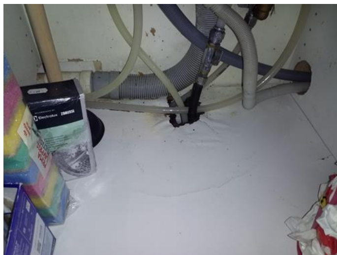
Kommentar - [Fuktmerke/skade i benkeskap på kjøkken.]
