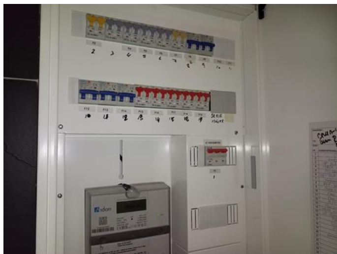
Forenklet vurdering av det elektriske anlegget - [Sikringsskap.]
