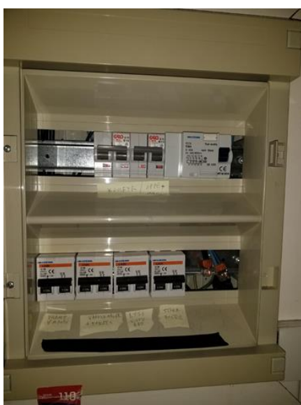
Elektrisk anlegg - [Sikringsskap anneks]
