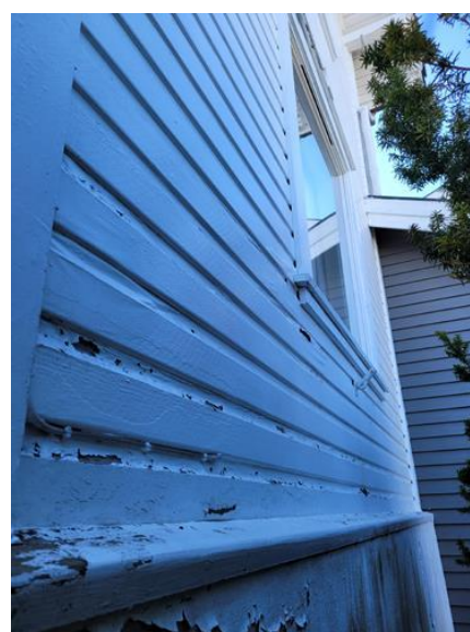
Fasader ink. kledning - [Råteskader vegg hovedhus]
