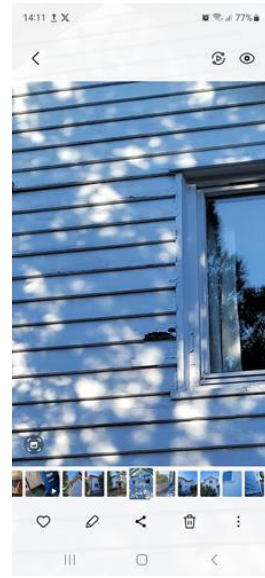
Fasader ink. kledning - [Råteskader vegg hovedhus]
