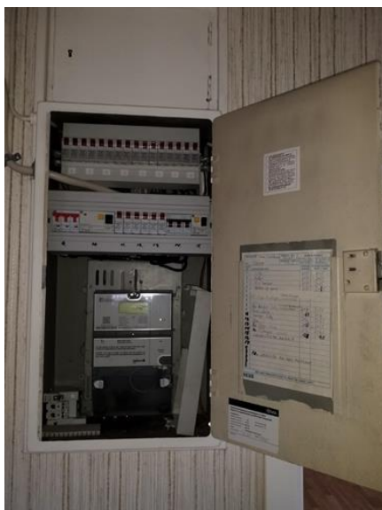
Elektrisk anlegg - [Sikringsskap]
