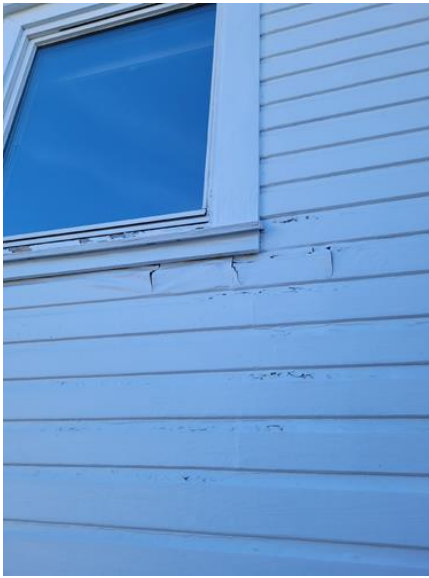
Fasader ink. kledning - [Råteskader vegg hovedhus]
