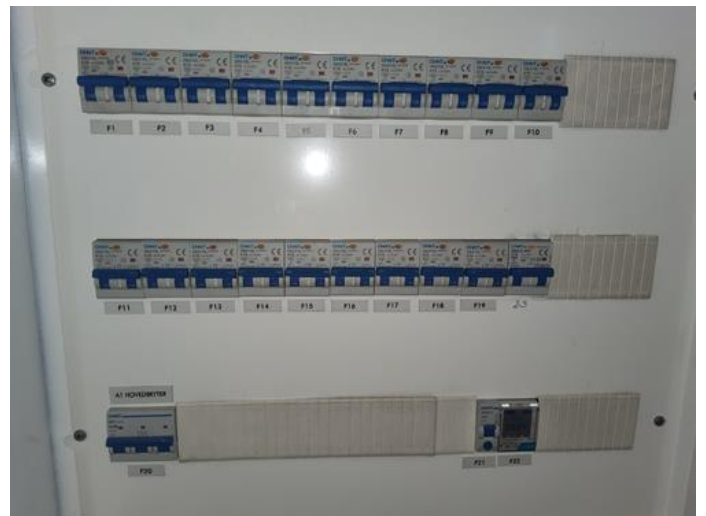
Beskrivelse - [Sikringskap entré 1.etasje ]
