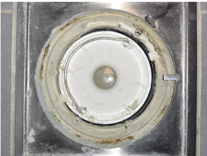
Kommentar - [Sluk vaskerom ]
