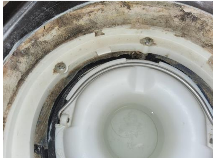
Kommentar - [Klemring sluk bad kjeller feilmontert ]
