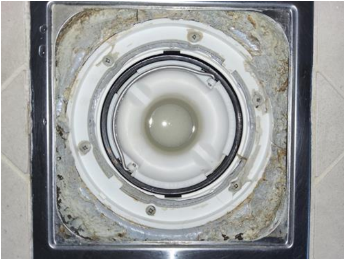
Kommentar - [Sluk dusjsonen bad 2.etasje ]
