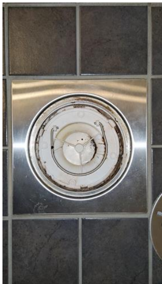
Avløpsrør (ink. sluk) - [Hundersætervegen 807B - Sluk (28.08.2023)]
