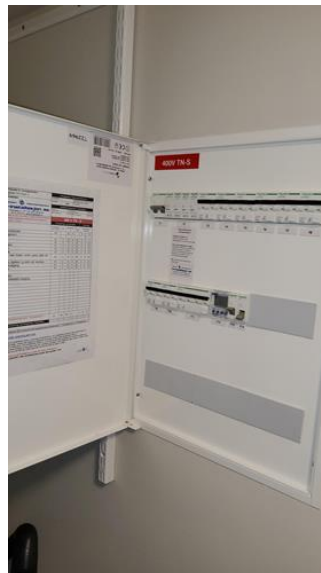
Elektrisk anlegg - [Hundersætervegen 807B - Sikringsskap (28.08.2023)]
