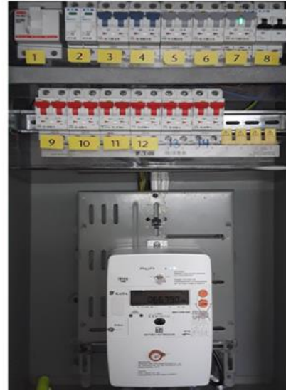
Elektrisk anlegg - [Sikringskap]
