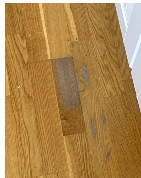
Flekker/misfarge på parkettgulv på stue
