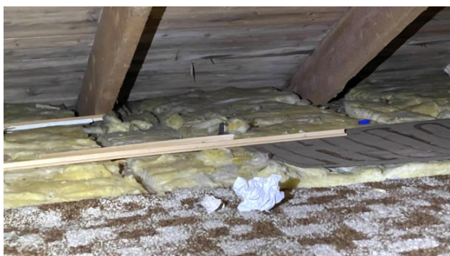
Liten og ingen lufting ved takfot
