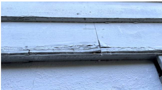
Råte i noen kledningsbord.
