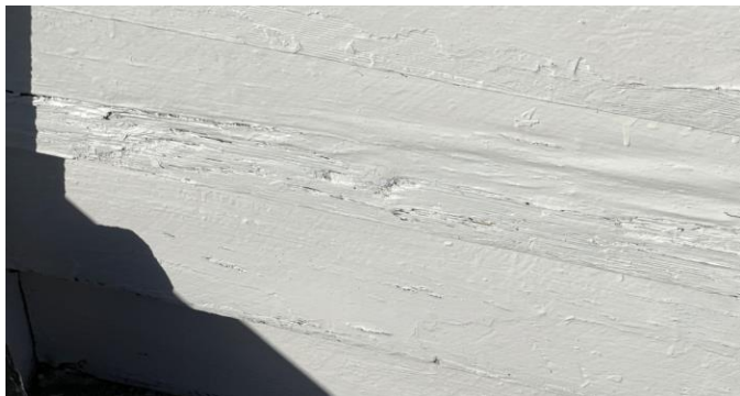
Råte i treverk
