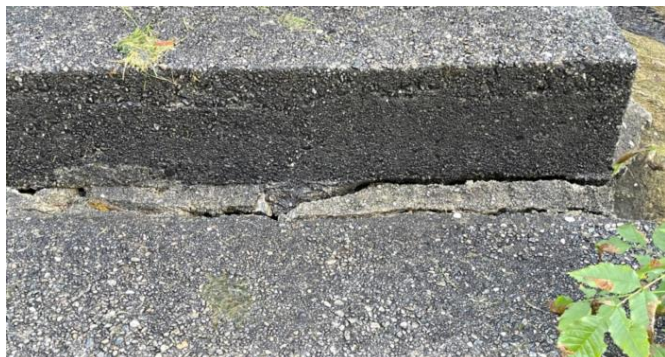
Sprukken og slitt betong i nedre trapp
