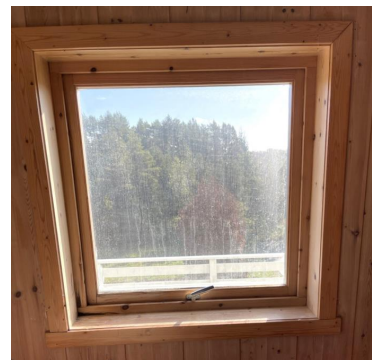
Vindu i underetasje med punktert glass.
