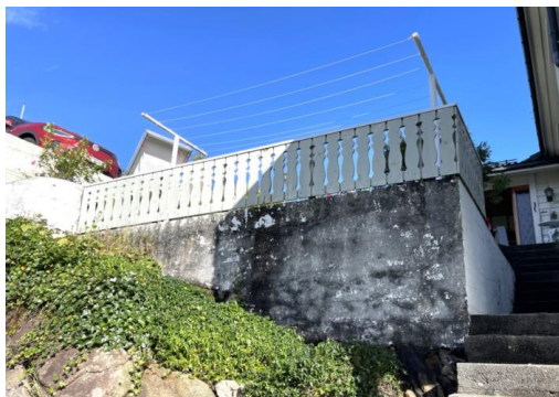
For lavt rekkverk
