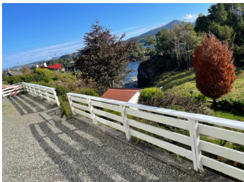
For lavt og tildels ustabil rekkverk mot syd-øst
