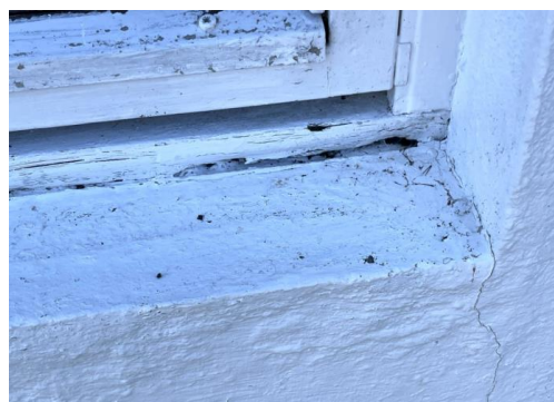
Et av vinduene med råte
