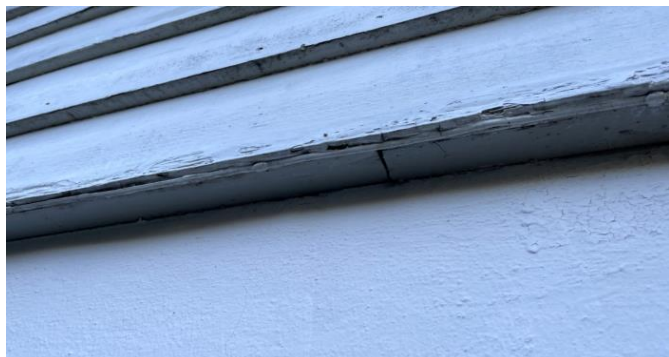
Manglende lufting under kledning på nord-vestvegg
