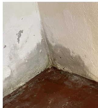
Fukt på gulv/vegg i hjørnet på bod som delvis går under trapp.
