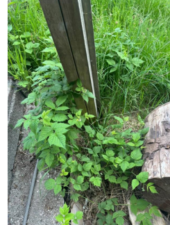
Tresøyle uten avstand til terreng.
