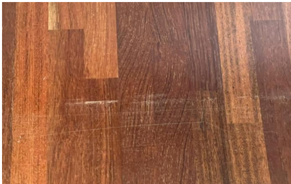
Bruksslitasje på parkettgulv
