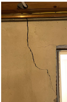
Setningsprekk på skillevegg i underetasje
