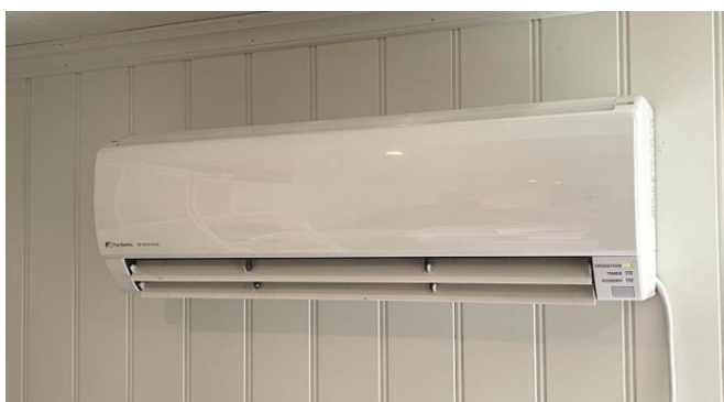
Varmepumpe i underetasje
