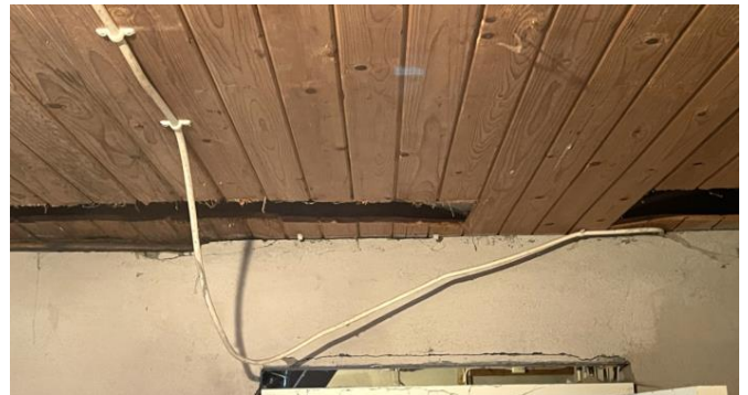
Løs ledning i vaskekjeller
