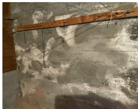
Saltutslag på innsiden av grunnmur i vaskekjeller
