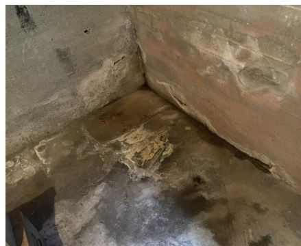
Saltutslag på vegg og fukt på gulv i hjørne mot syd-vest vaskekjeller
