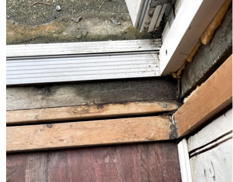
Fuktinnslag via kjellerdør
