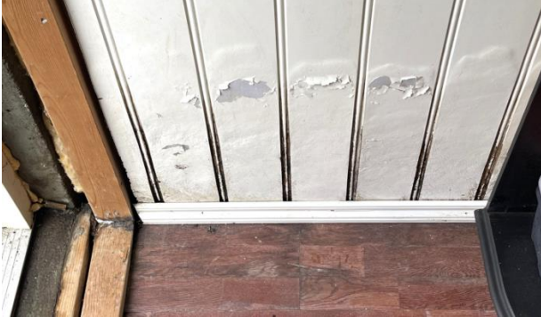
Fuktskadet veggplate ved kjellerdør
