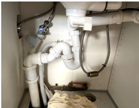
Avløpsrør under kjøkkenvask
