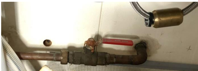
Kobberrør med rust på stengeventil under kjøkkenvask
