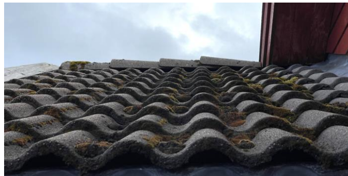
Mose på takstein, sett fra altan.
