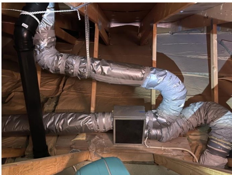
Avtrekksmotor på kaldloft
