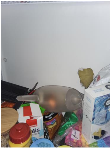
Overflater vegger - [Hull i veggflate i bod bak kjøkken ]
