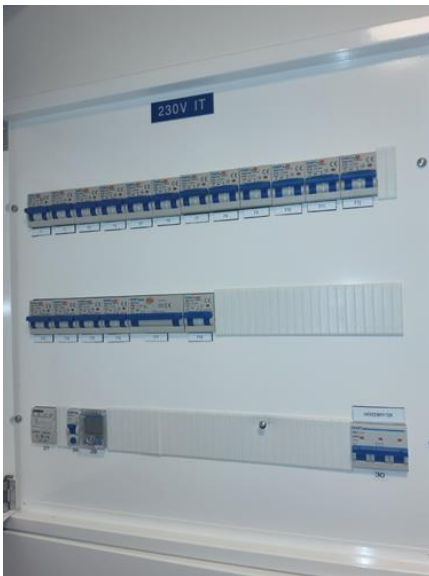
Elektrisk anlegg - [Sikringskap ]
