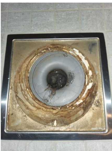
Våtrom - [Sluk bad 1.etasje ]
