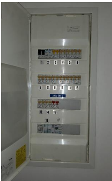
Elektrisk anlegg - [Sikringskap]
