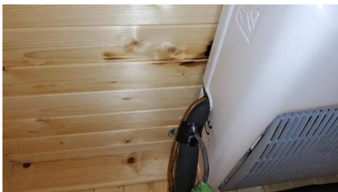
Tekniske anlegg - [Gammelseterlia - Kjølerom - Himling (14.03.2024)]
