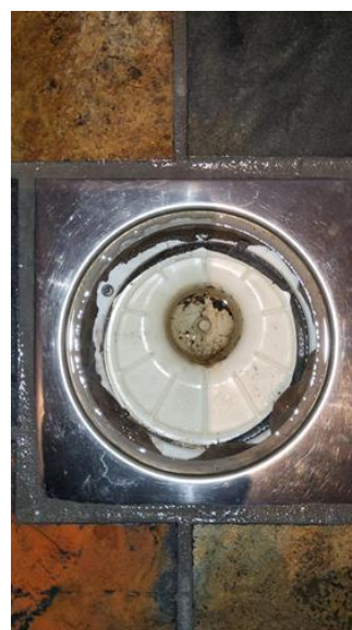
Avløpsrør (ink. sluk) - [Gammelseterlia - Bad4 - Sluk (14.03.2024)]
