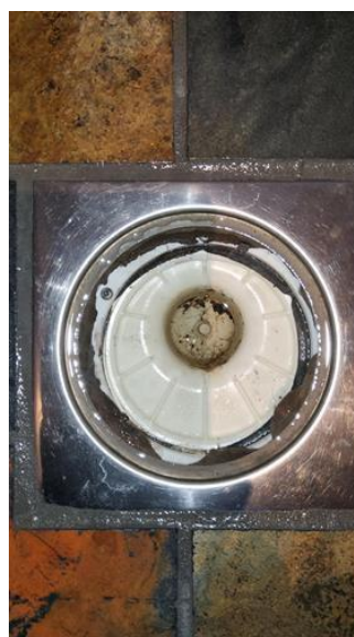
Avløpsrør (ink. sluk) - [Gammelseterlia - Bad4 - Sluk (14.03.2024)]
