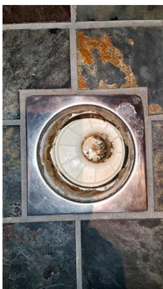
Avløpsrør (ink. sluk) - [Gammelseterlia - Bad3 - Sluk (14.03.2024)]
