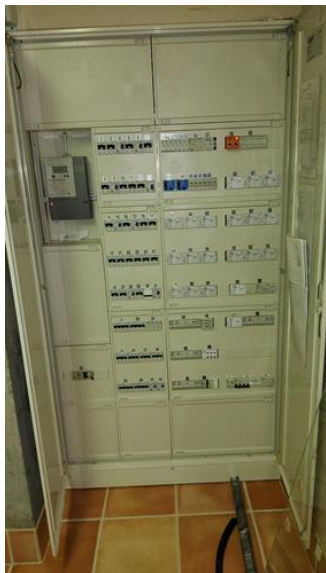
Elektrisk anlegg - [Gammelseterlia - Sikringskap (14.03.2024)]
