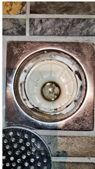
Avløpsrør (ink. sluk) - [Gammelseterlia - Bad2 - Sluk (14.03.2024)]
