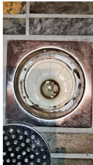
Avløpsrør (ink. sluk) - [Gammelseterlia - Bad2 - Sluk (14.03.2024)]
