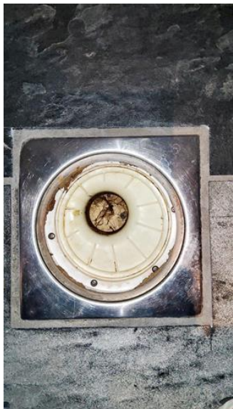
Avløpsrør (ink. sluk) - [Gammelseterlia - Bad1 - Sluk (14.03.2024)]
