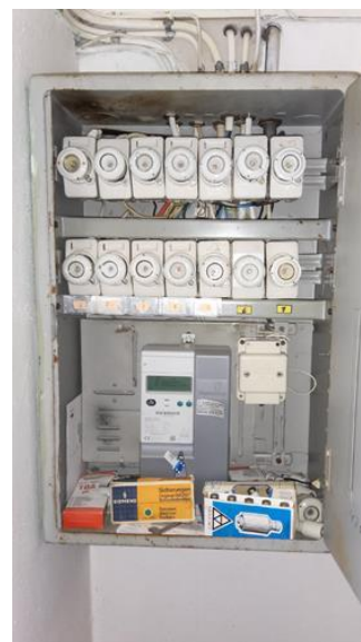
Elektrisk anlegg - [Sikringskap i gang underetasje ]
