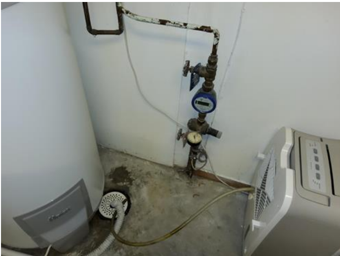
Tekniske anlegg, VVS anlegg (Sjekkpunkter utover det som er inkludert i andre rom) - [Hovedstoppekran]
