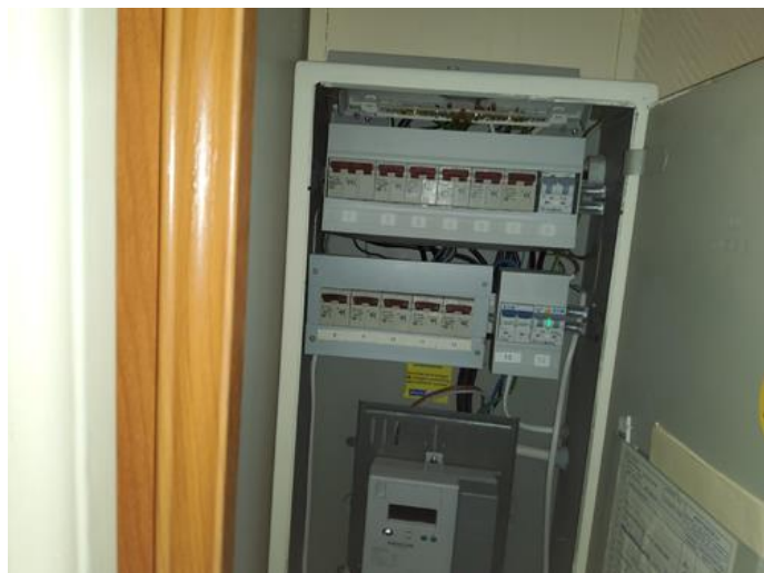
Elektrisk anlegg - [Sikringskap]
