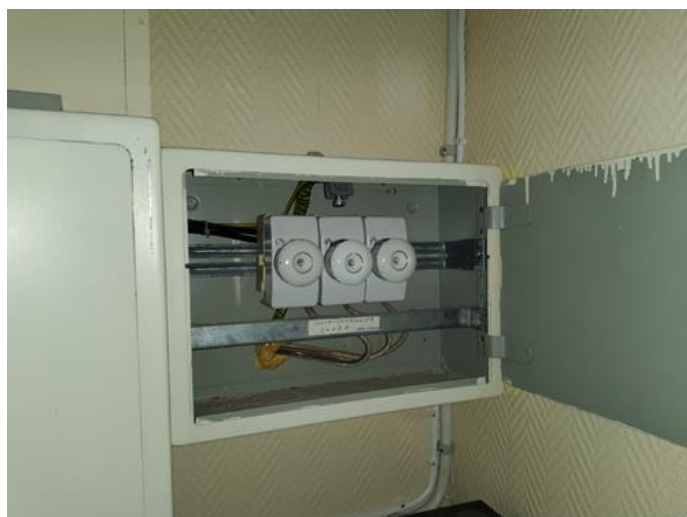
Elektrisk anlegg - [Hovedsikring]
