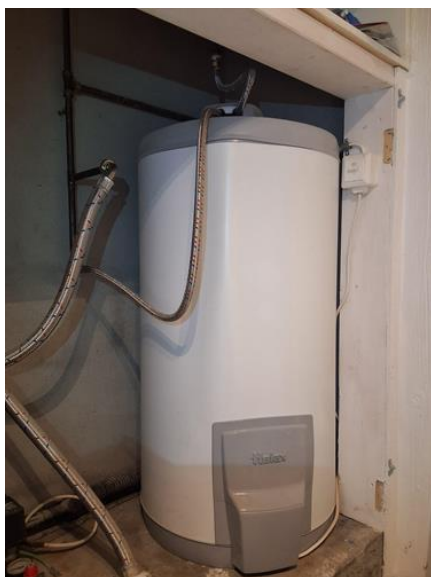
Varmtvannsbereider (Sjekkpunkter utover det som er inkludert i andre rom) - [VVB i kjeller]
