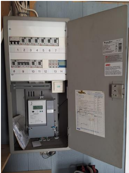
Elektrisk anlegg - [Sikringskap i kjeller]
