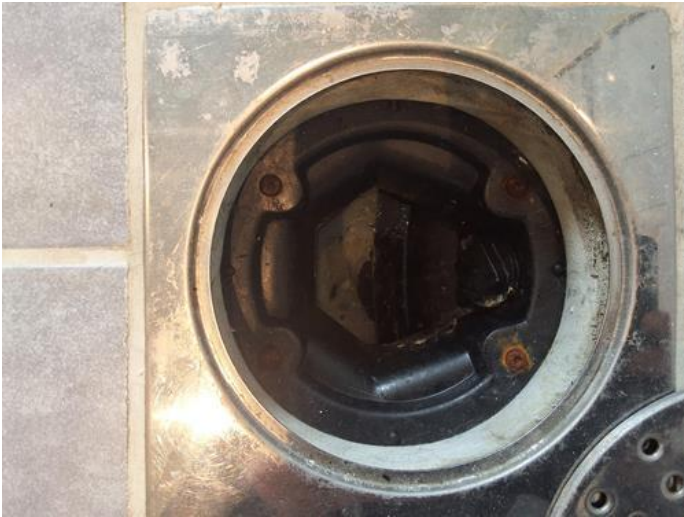
Våtrom - [Sluk midt på gulvet på badet]
