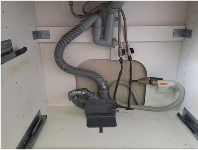
Kjøkken - [Røropplegg i kjøkkenbenk]
