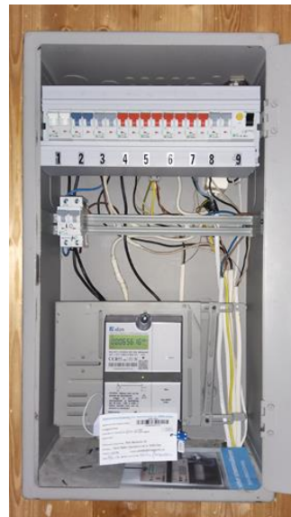
Elektrisk anlegg - [SikSikringskap plassert i trappeløp til kjelleretasje]
