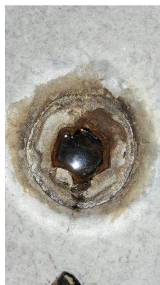
Avløpsrør. (Sjekkpunkter utover det som er inkludert i andre rom) - [Sluk i kjellerrom 1]
