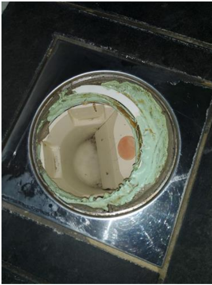
Våtrom - [Sluk i dusjsonen 2. etg.]
