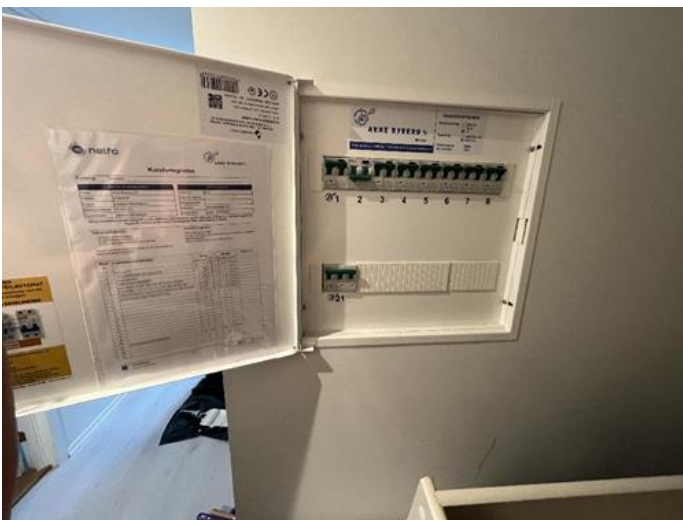
Elektrisk anlegg - [Sikringskapet i U. etg.]
