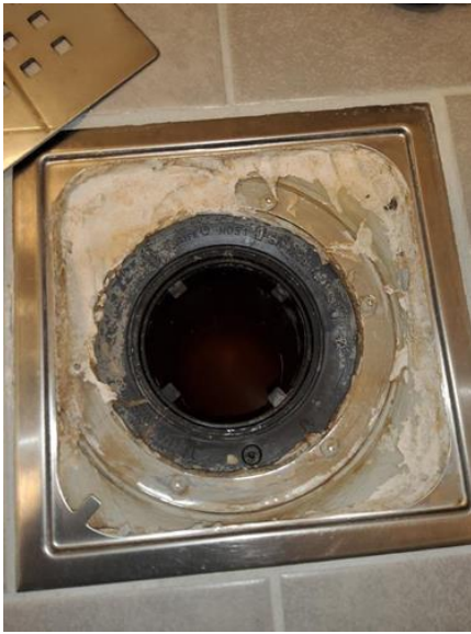
Våtrom - [Sluk på bad]
