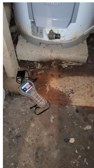
Innvendig inspeksjon - [Tilsig av fukt i grunn/fuktmåling med pigg i søyle/rustdannelser på varmtvannsbereder - Krypekjeller]
