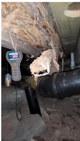
Innvendig inspeksjon - [Råteskade og fuktmåling med pigg i trebjelke - Krypekjeller]
