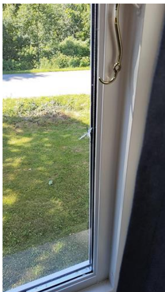
Vinduer - [Sprekk i vindu - Spisestue]
