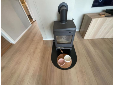
Pipe med brannmur, vedovn og stålplate på gulv.
