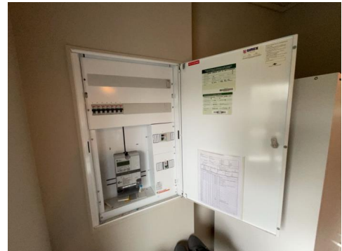
Automatsikringer i el skap fra 2003.
