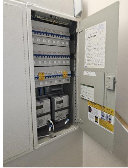
Elektrisk anlegg - [Sikringskap med automatsikringer plassert i felles gang]
