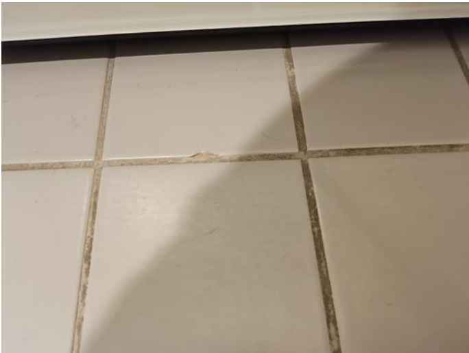
Våtrom - [Hakk i flis under servantinnredning.]
