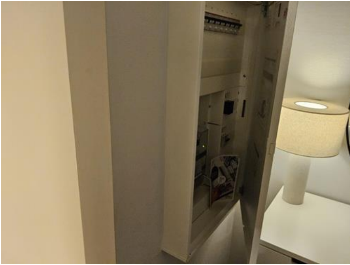
Elektrisk anlegg - [Sikringskap.]
