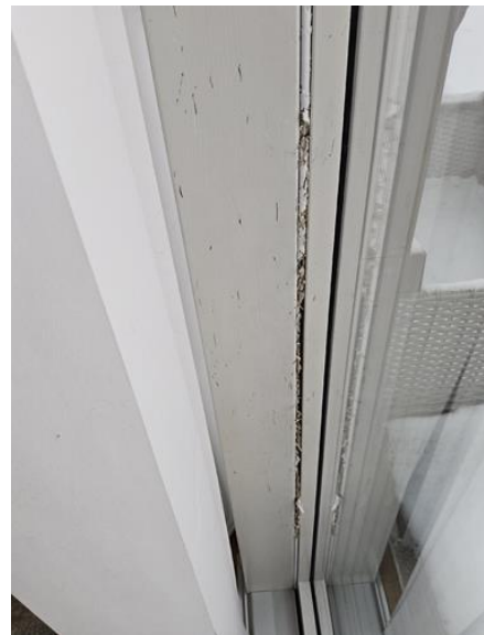
Dører og vinduer - [Skader på pakning til skyvedør.]
